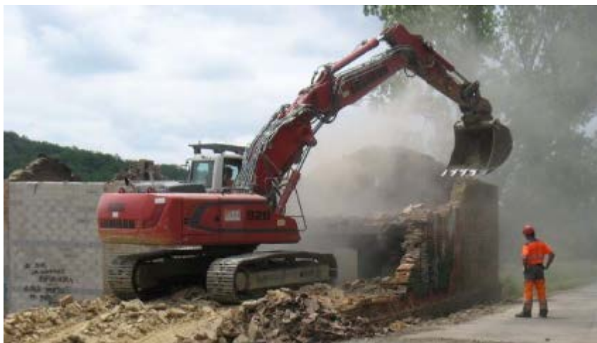
Destruction de la Métairie Neuve le 1 er juin 2015 / Photo DDM
