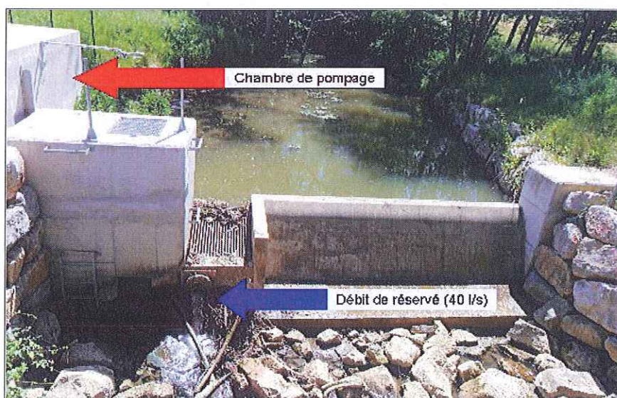
Figure n° 3 : Fonctionnement de la prise d'eau sur le Tescounet
